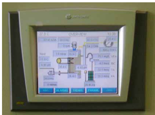
Foto 3. Universaalkontrolleris loodud juhtimisüsteem. Photo 3. Interface of Programmable Logic Controller.
