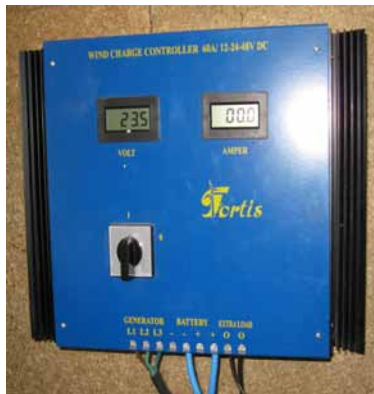
Joonis 4. Tuulegeneraatori kontrolleri, mis paremas näidikus näitab laadimist amprites ja vasakus näidikus laadimist ja aku täituvust voltides Figure 4. Controller for windturbine
